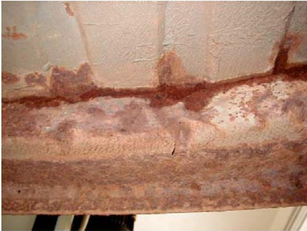
没有 PVC 涂层腐蚀严重
