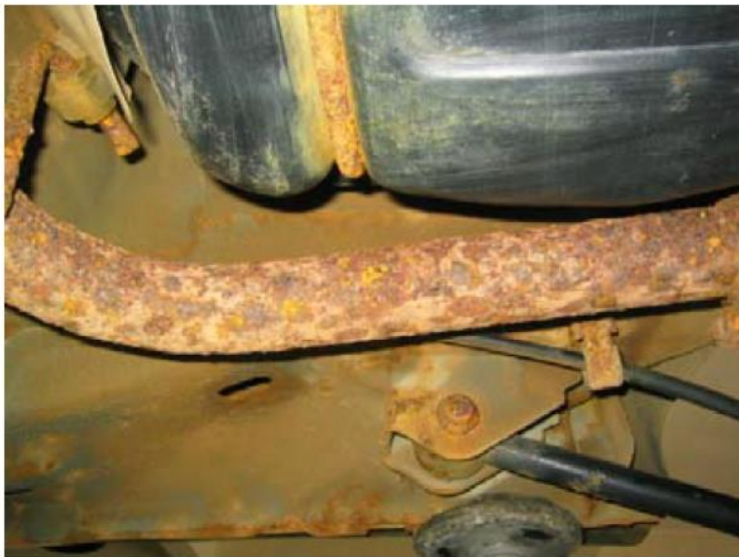
普碳钢排气管腐蚀严重
